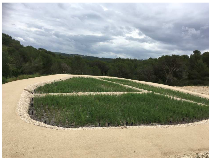
Station d'épuration de Vernègues Village - juin 2018
