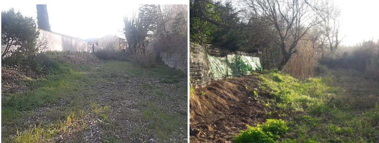
Mallemort Pont-Royal : Murs et clôtures en bordure immédiate du canal de Craponne
